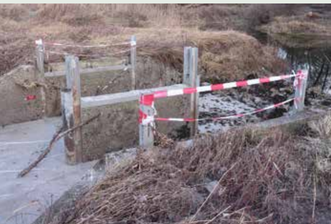
FV Haslau: Derzeit gesperrte Brücke am Krickeldamm
