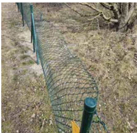
Am Teich Lobau haben Vandalen den neu errichteten Gartenzaun stark beschädigt.
