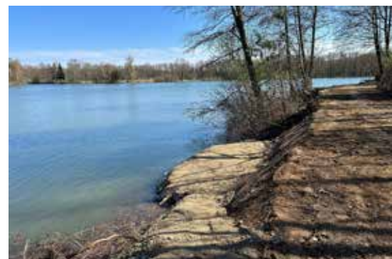
Perfekter Ersatz für die beiden maroden Holzstege an der Westseite des Ghartwaldsees: ein wartungsfreier und nachhaltiger Steinwurf.
